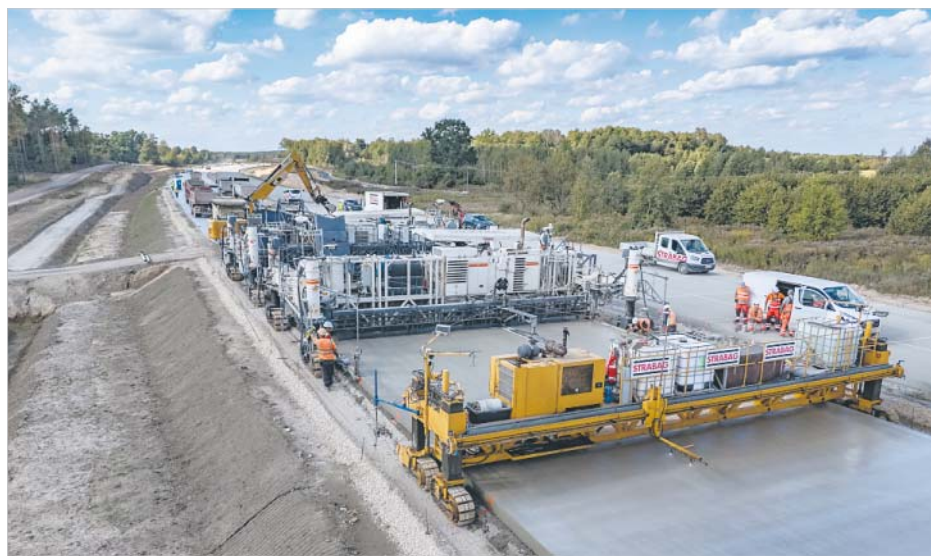
Na odcinku A2 Siedlce Zachód-Malinowiec STRABAG po raz pierwszy w Polsce zastosował niskoemisyjny beton
