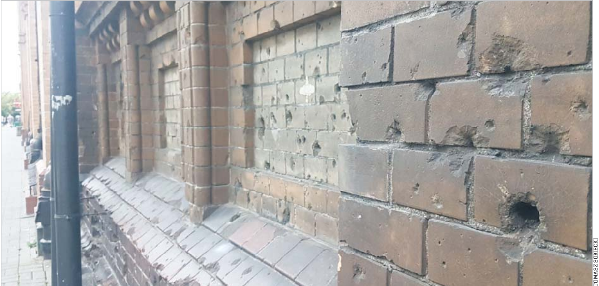
Mur Hali Mirowskiej ze śladami po egzekucjach w czasie okupacji niemieckiej. Po alarmistycznych artykułach zachowany podczas restauracji obiektu, jest wciąż mało znany, a ekspozycja nie wygląda tak, jak powinna.
